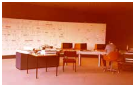
Stromleitwarte der Stadtwerke Aachen 1973.
